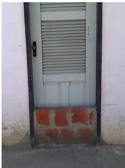
Figura 6 – Batente para conter águas pluviais em residência no ponto (P06).
