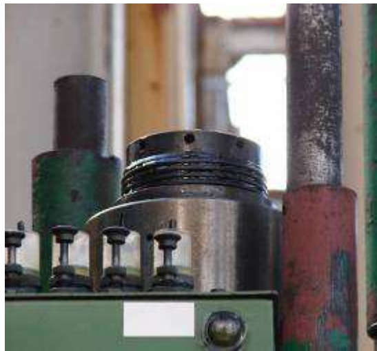
Figura 7- Corrosão na haste
