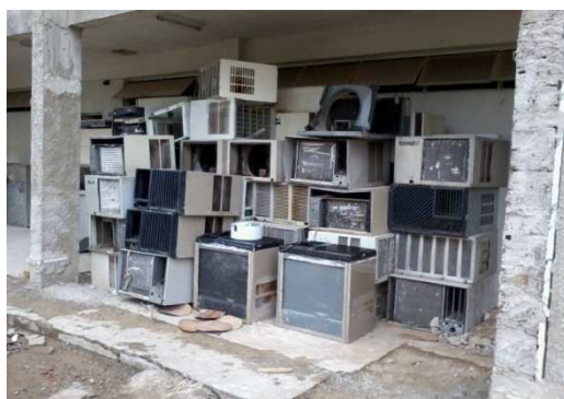
Fig. 4 – Aparelhos ar condicionados danificados.
