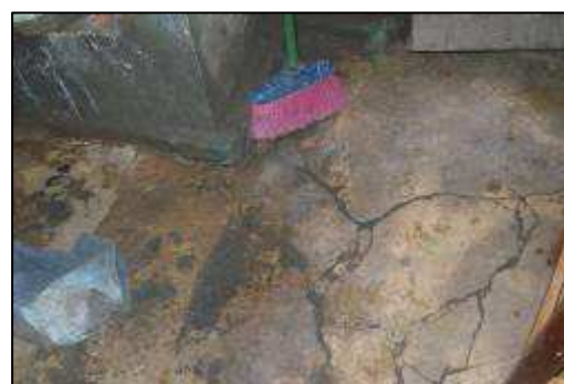
Figura 10 - Descolamento no piso
