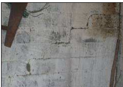
Figura 9 – Bolor e Manchas de Infiltração
