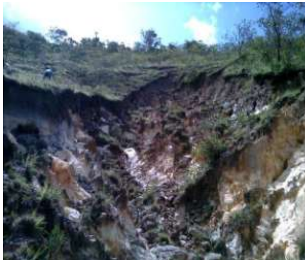
Figura 3 - Área com feições erosivas (voçoroca) e solo exposto aos fenômenos naturais.
