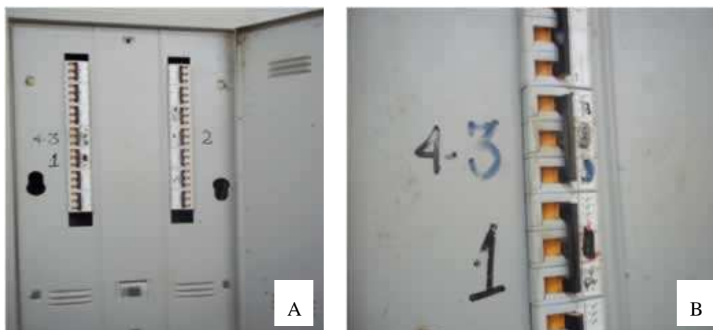
Figura 02 – Quadro de Distribuição de Circuitos (A). Numeração dos disjuntores (B).
