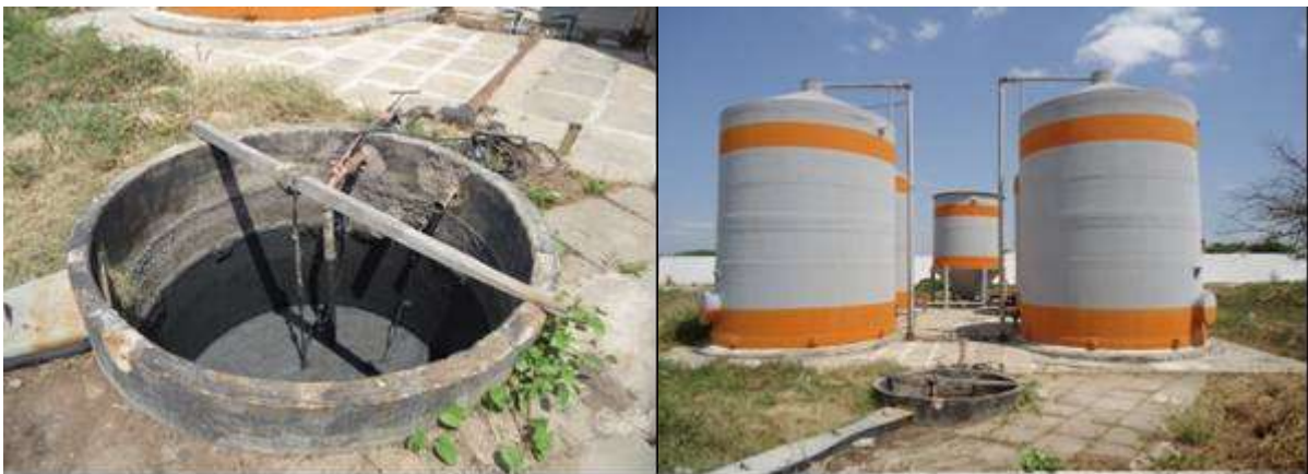
Figura 2 - Sistemas de recebimento de esgoto bruto (esquerda) e filtragem e tratamento (direita)
