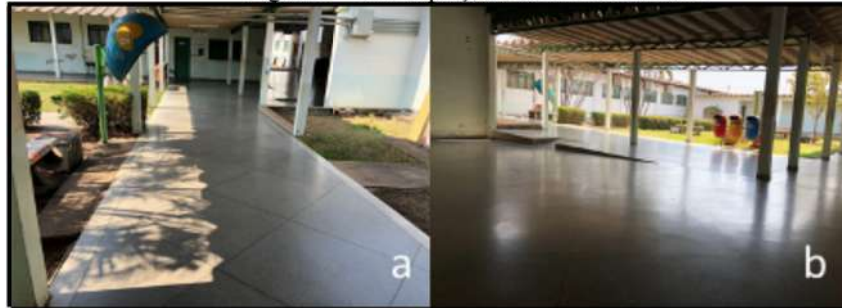
a- rampa de grande comprimento; b- piso com desníveis
