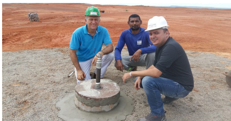
Figura 1 – Adaptação do sistema para captação de gases no Aterro Sanitário de Palmas - Tocantins
