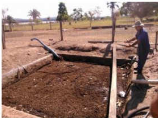
Figura 3- Instalações do biodigestor: tanque de armazenamento.
