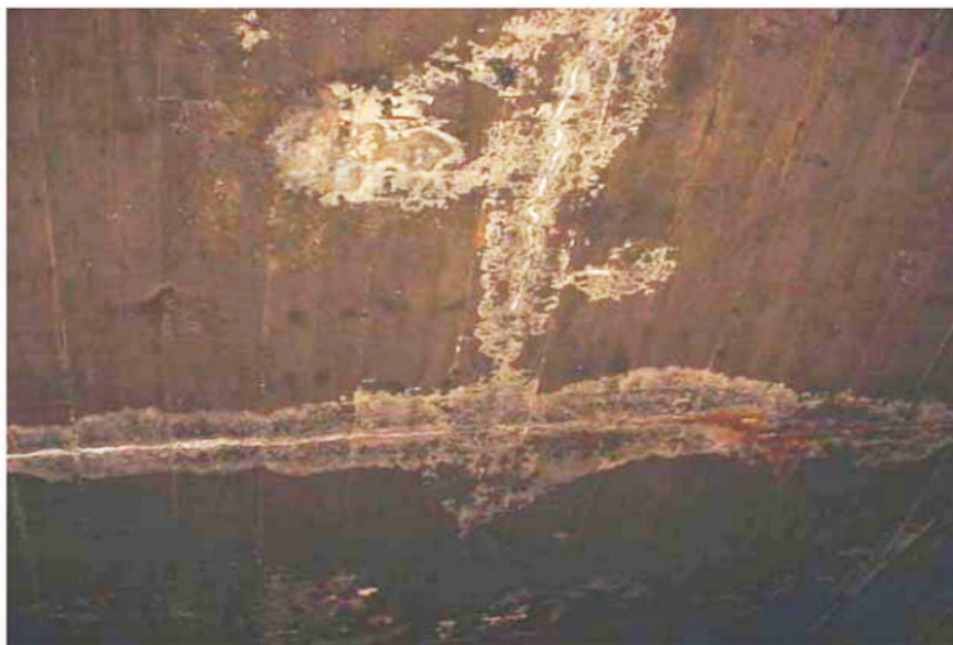
FIGURA 5 - Carbonatação do concreto e armaduras expostas.
