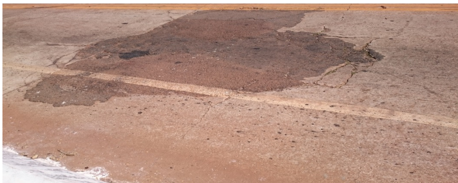
Figura 3- Buraco tapado com revestimento asfáltico no trecho 1 Fonte: Guilherme (2015).
