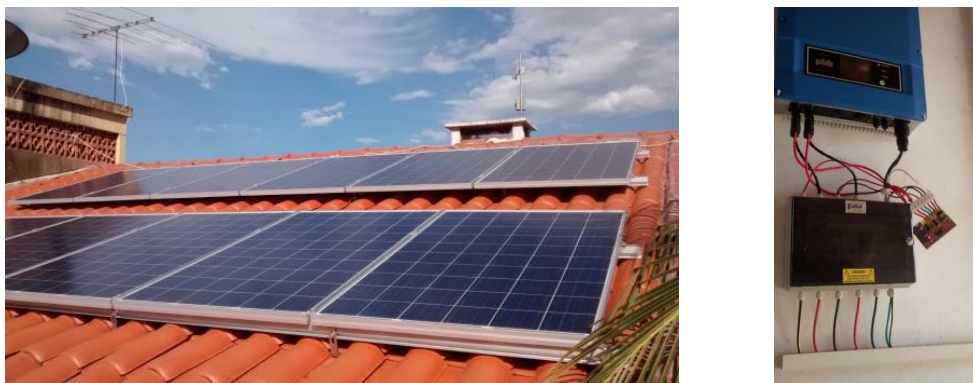
Figura 3 - Sistema FV de 3,12 KWp e circuito de monitoramento.
