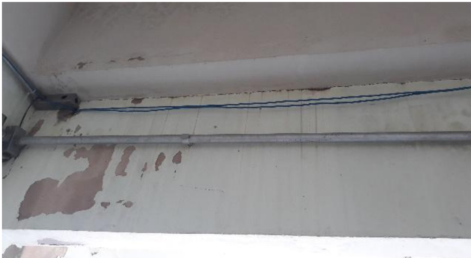
Figura 05-Parede interna do corredor que direciona a escada de acesso ao pavimento superior:
