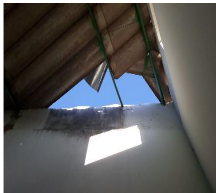
Figura 08- Cobertura apresentando falta de telha
