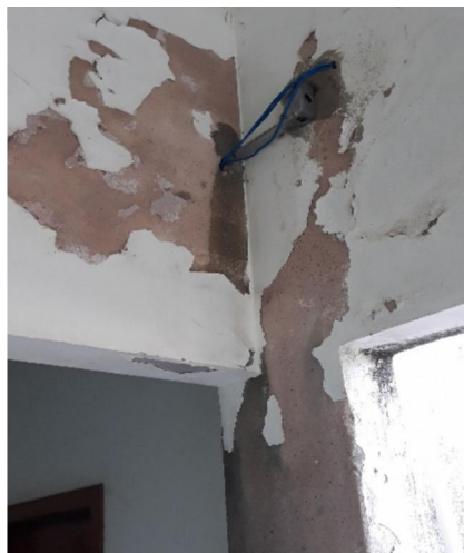
Figura 04- Marquise do Bloco apresentando descascamento do revestimento
