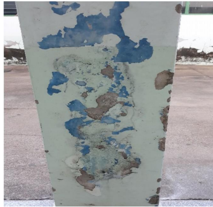
Figura 03- Pilar com descascamento superficial e mofo
