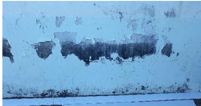
Figura 01- Parede externa apresentando descascamento
