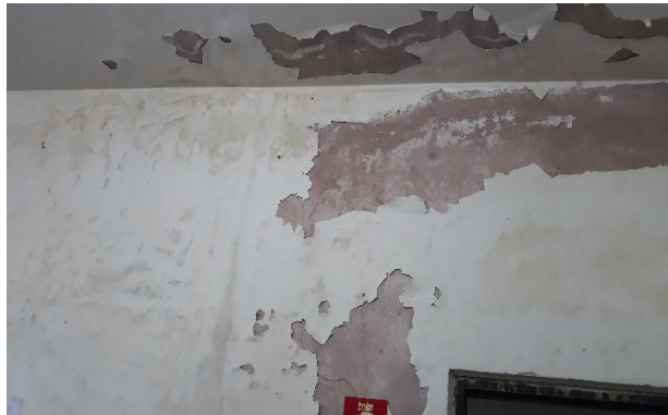
Figura 07- Parede interna do labin B com infiltração
