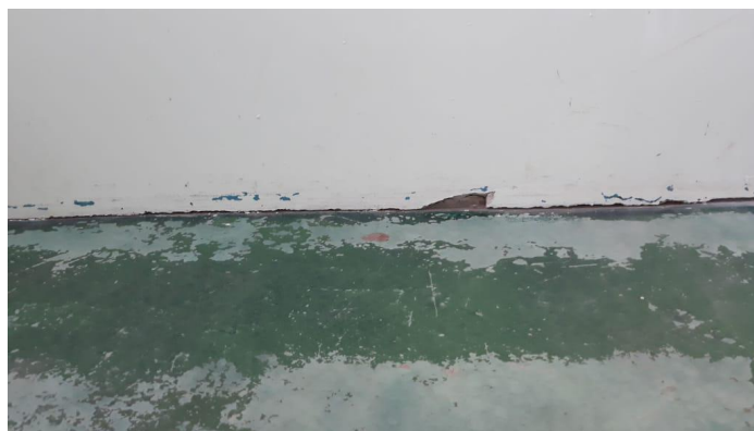
Figura 16-Parede constando rachadura em sua ligação com a laje
