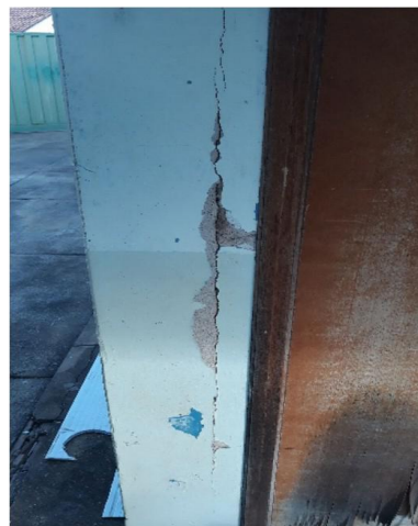
Figura 02- Fissura na parede, abertura média.
