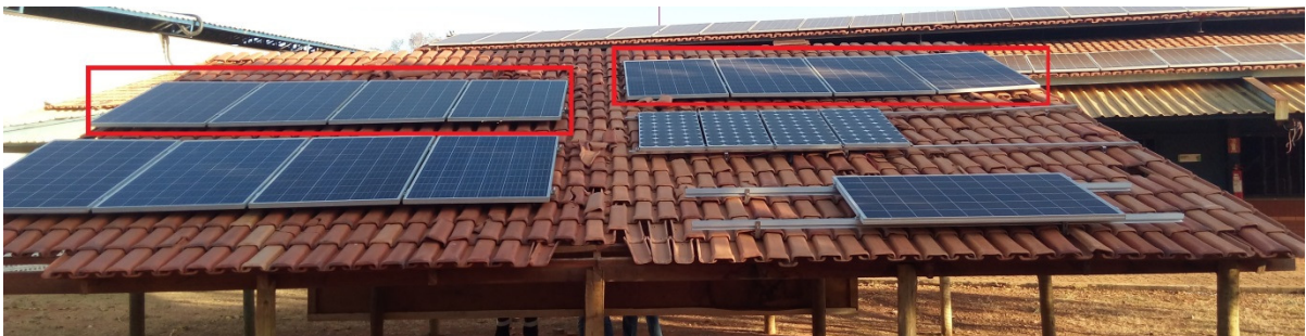
Figura 1 - Imagem dos sistemas no telhado instalado no IFTO - campus Palmas.
