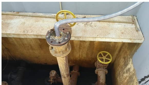
Figura 1 - Registro de descarga do tanque de decantação da ETA 6 e coleta do lodo
